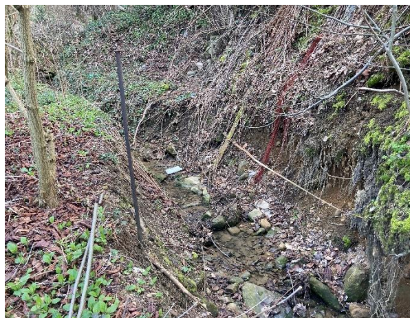
FOTO 19 – Břehová eroze koryta IDVT 10212610
