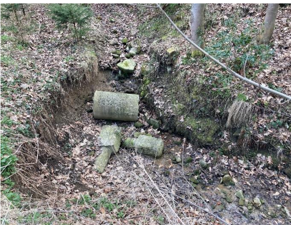
FOTO 20 – Utržené betonové potrubí a splavené kusy betonu
