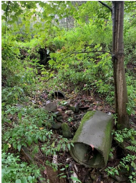
FOTO 13 – Utržená část svahu a odlomené potrubí nekapacitního propustku
