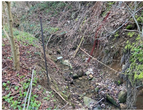
FOTO 19 – Břehová eroze koryta IDVT 10212610
