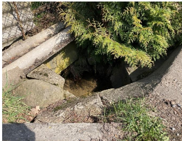
FOTO 21 – Někapsitní nátok do potrubí pod místní komunikací
