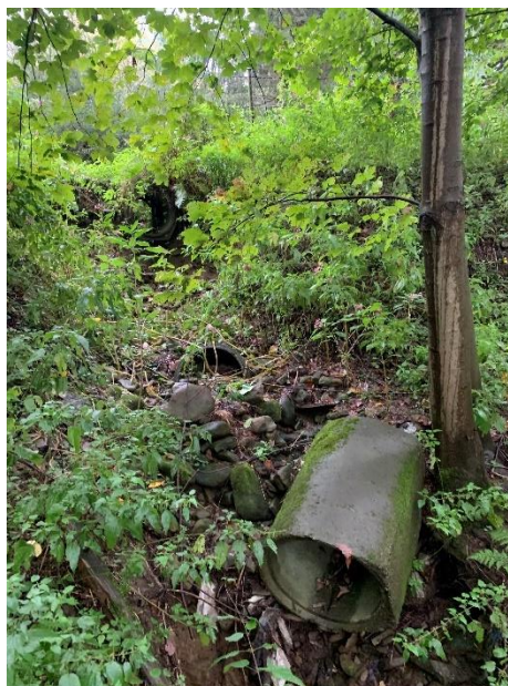
FOTO 13 – Utržená část svahu a odlomené potrubí nekapacitního propustku u vyústění ze zahrad
