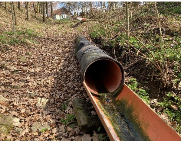
FOTO 18 – Nevhodně vyústěné potrubí do toku IDVT 10212610
