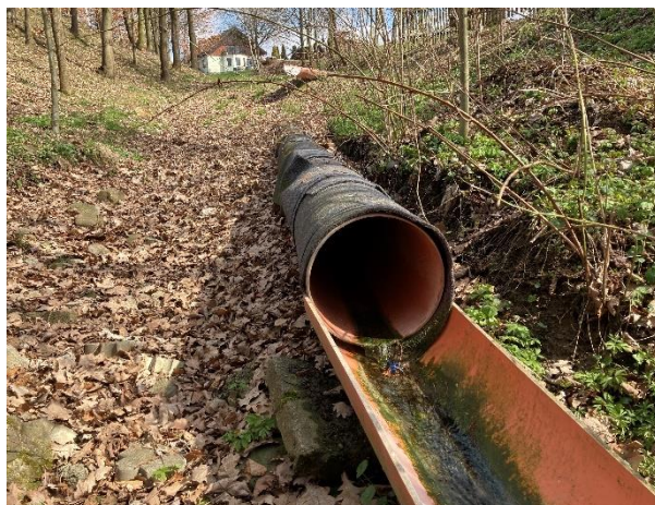
FOTO 18 – Nevhodně vyústěné potrubí do toku IDVT 10212610
