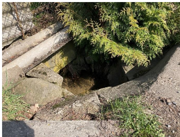
FOTO 21 – Nekapacitní nátok do potrubí pod místní komunikací
