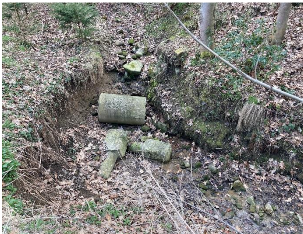
FOTO 20 – Utržené betonové potrubí a splavené kusy betonu
